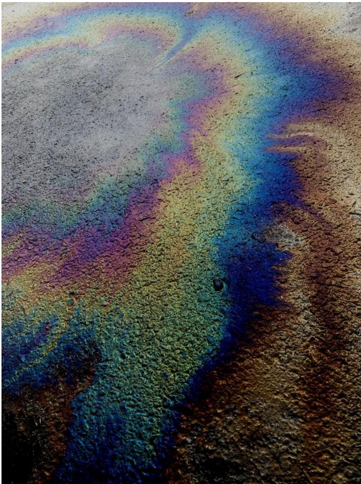
Figura 16 — Mancha de óleo sobre asfalto 3
