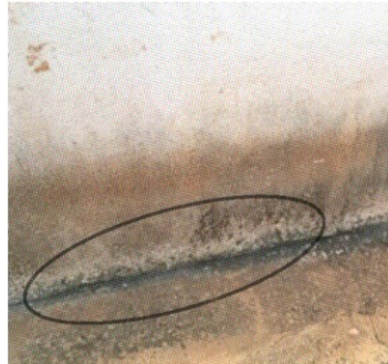
EXEMPLO DE INFILTRAÇÃO
