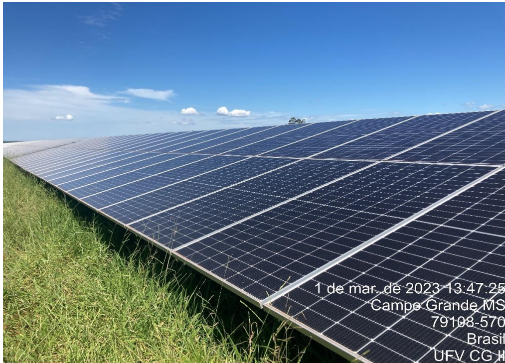
Figura 4 - Arranjo de módulos fotovoltaicos
