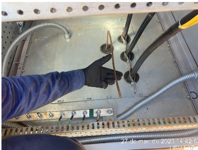
Figura 24 - Cabos de aterramento desconectados
