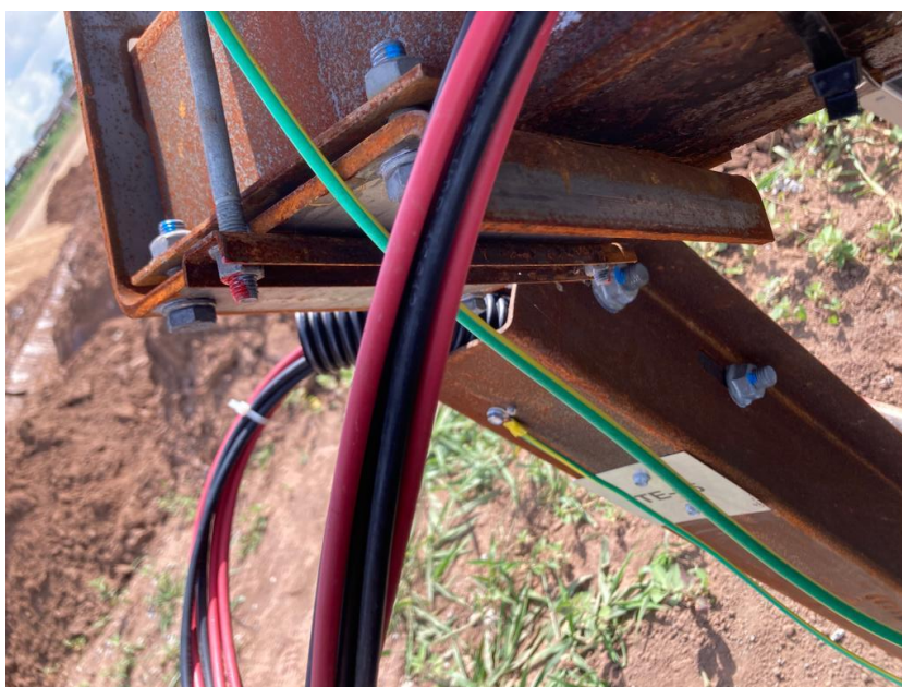
Figura 18 - Cabos amarrados de forma incorreta
