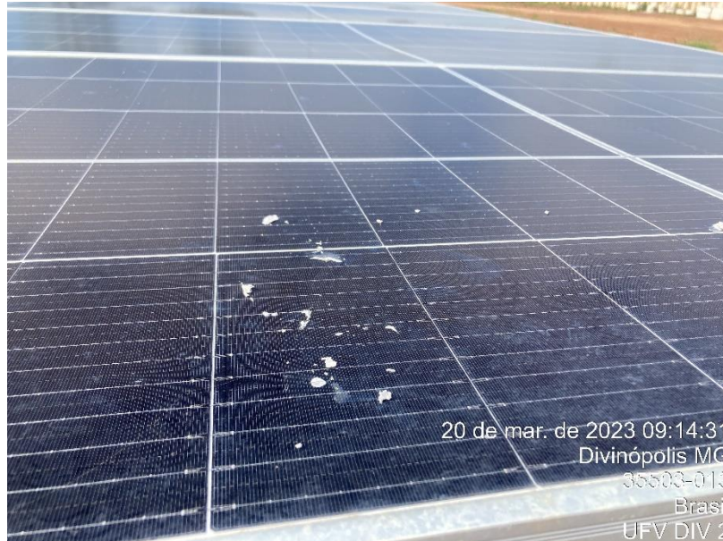
Figura 21 - Módulo fotovoltaico com uma massa utilizada para tampar os eletrodutos
