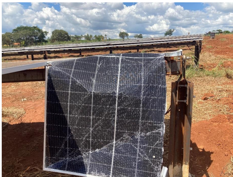
Figura 22 - Módulo fotovoltaico quebrado.
