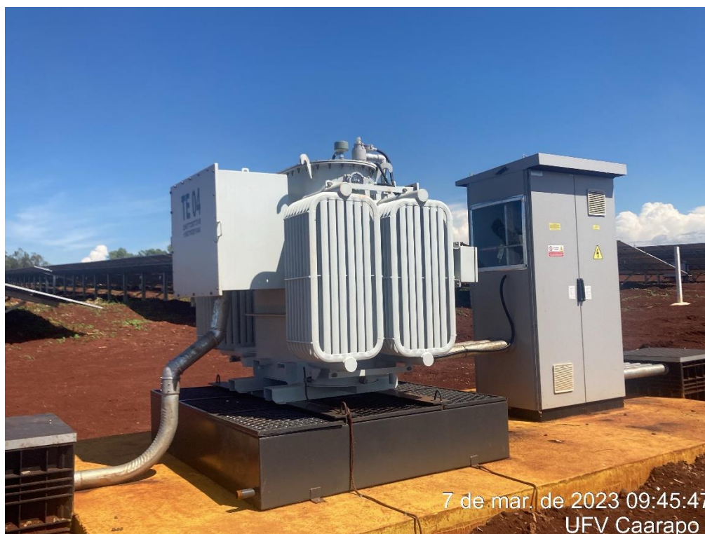
Figura 8 - Transformador de acoplamento a óleo
