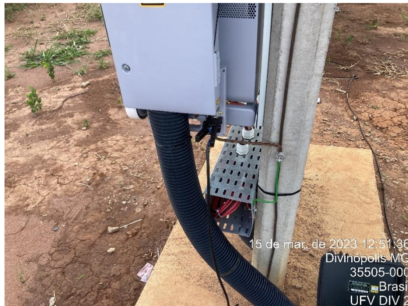
Figura 36 - Medição do inversor ao ponto de aterramento
