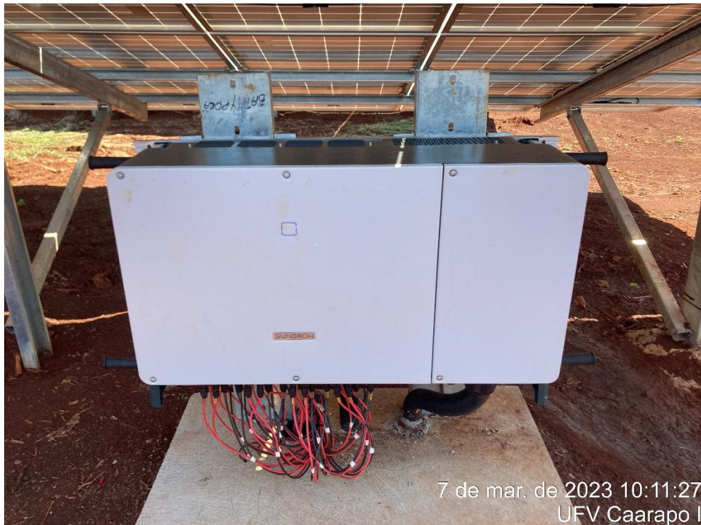
Figura 5 - Inversor solar de grande porte
