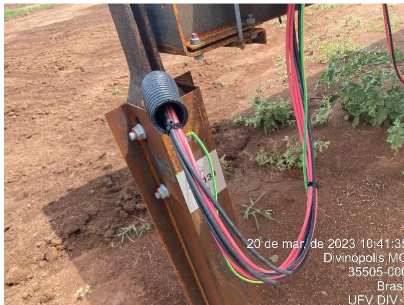
Figura 20 - Eletroduto sem vedação
