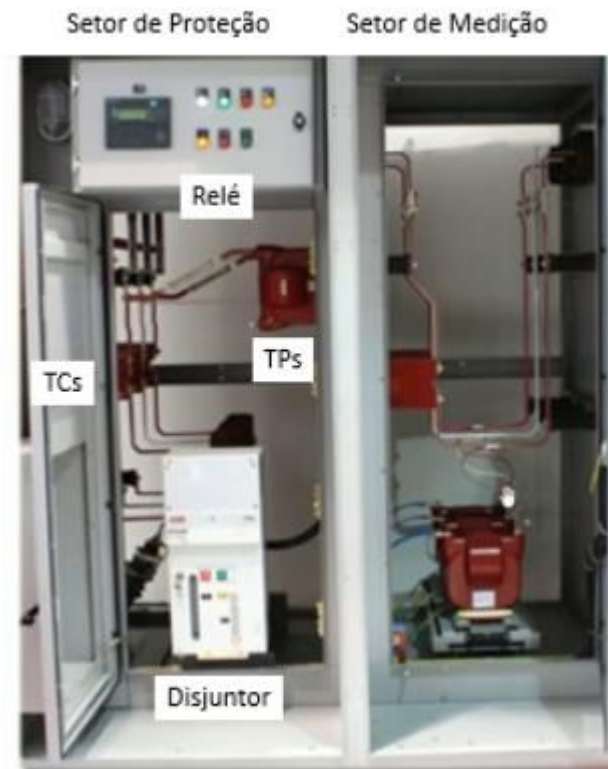
Figura 6 - Setor de medição e proteção da cabine de seccionamento
