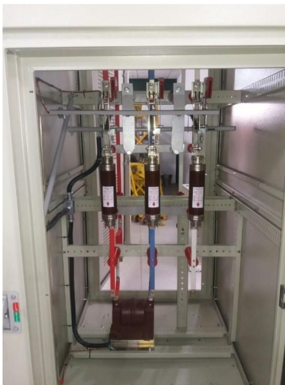
Figura 7 - Cabine de seccionamento
