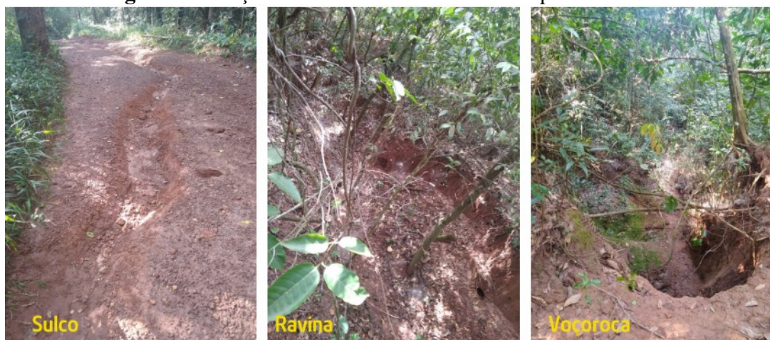
Figura 23: Feições erosivas localizados no Parque do Goiabal.
