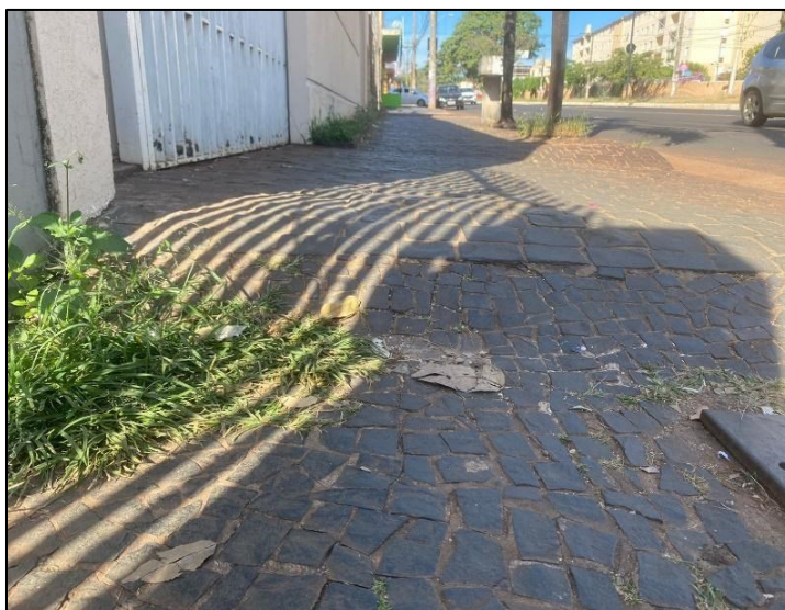
Figura 95: Desníveis decorrente do acesso de veículos aos lotes no trecho 7 (sentido oeste x leste)
