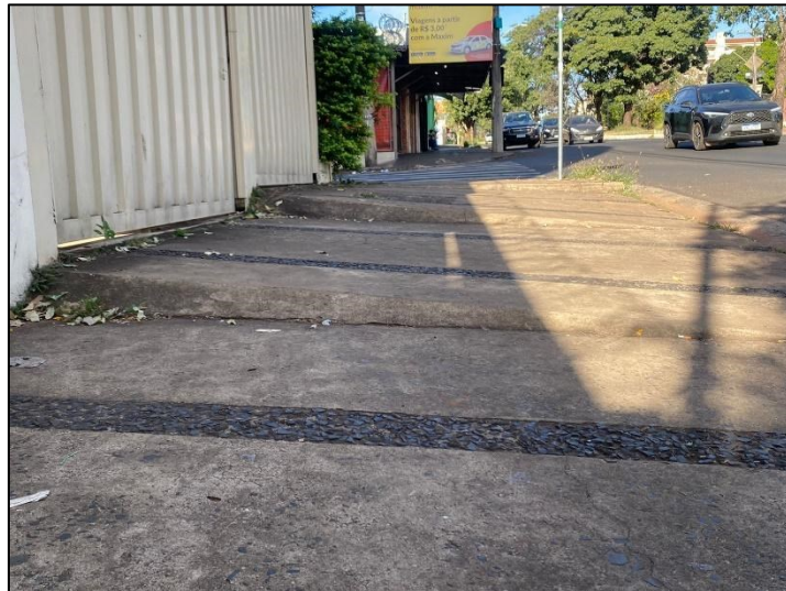
Figura 94: Desníveis decorrente do acesso de veículos aos lotes no trecho 9 (sentido oeste x leste)
