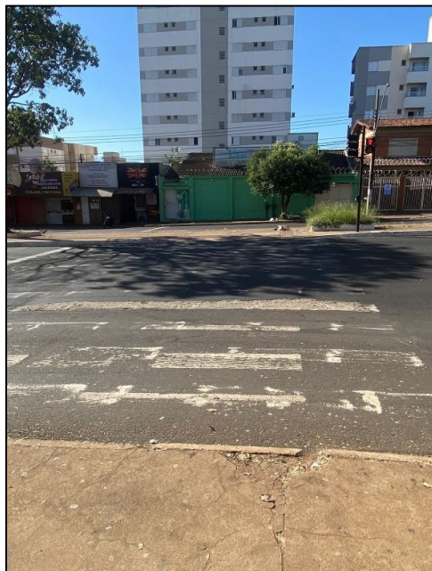
Figura 75: Má conservação da faixa de pedestres trecho 8 (sentido leste x oeste)
