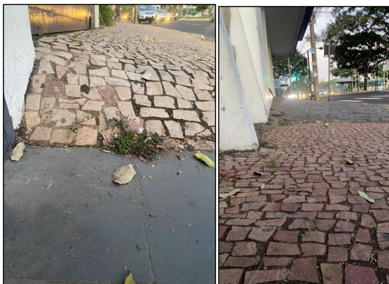
Figura 85 : Degraus na calçada no trecho 3 (sentido oeste x leste)
