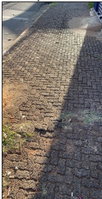
Figura 84: Calçada com revestimento trepidante no trecho 2 (ambos os sentidos)
