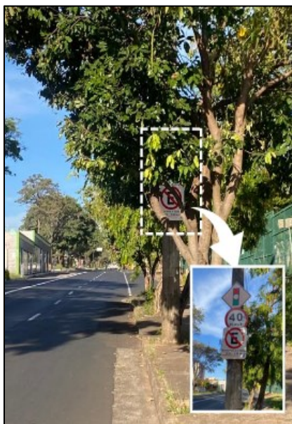
Figura 77: Sinalização vertical encoberta por vegetação no trecho 9 (sentido leste x oeste)
