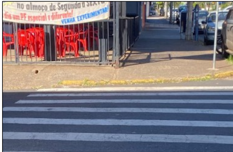
Figura 92: Rebaixo na calçada fora do alinhamento da faixa de pedestres entre os trechos 5 e 6 (sentido oeste x leste)
