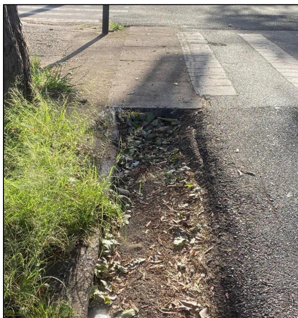
Figura 79: Elemento de drenagem obstruído no trecho 3 (sentido leste x oeste)
