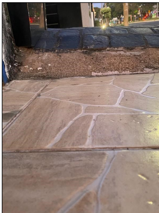
Figura 86: Degrau na calçada no trecho 4 (sentido oeste x leste)
