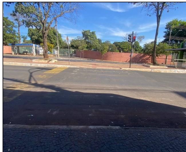
Figura 76: Má conservação da faixa de pedestres trecho 8 (sentido oeste x leste)
