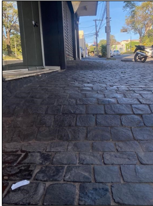
Figura 87: Degrau na calçada, trecho 10, sentido oeste x leste
