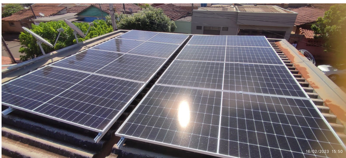
Figura 26 – Sistema off-grid instalado
