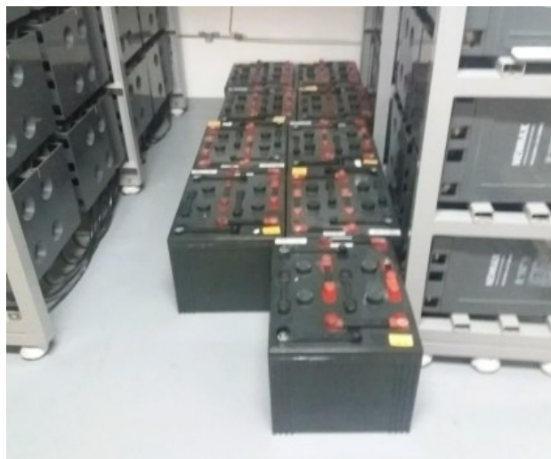
Figura 19 – Baterias do banco de baterias (sistema off-grid )
