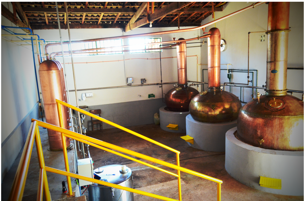
Figura 3.1 – Sala de destilação da cachaçaria Vanderley Pereira de Azevedo - ME
