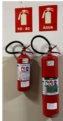
Figura 27 - Extintores de incêndio localizados ao lado da entrada da sala onde são ministradas as aulas de Histologia, no bloco 2B, Campus Umuarama da UFU.
