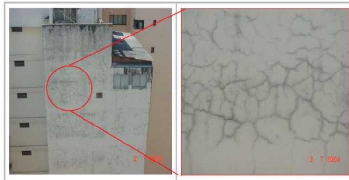
Figura 19 - Fissuras devido a fadiga hidrotérmica
