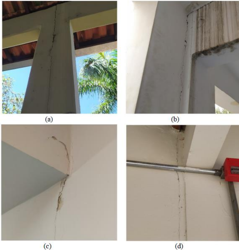
Figura 12 - Fissurações por ausência de juntas de dilatação
