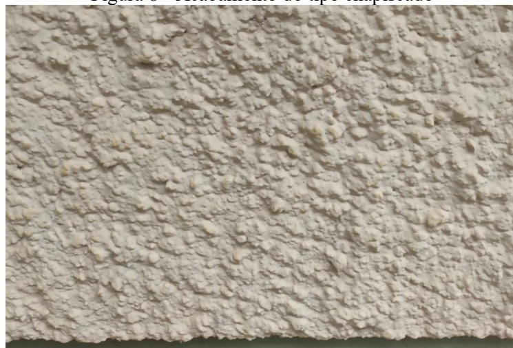
Figura 8 - Acabamento do tipo chapiscado
