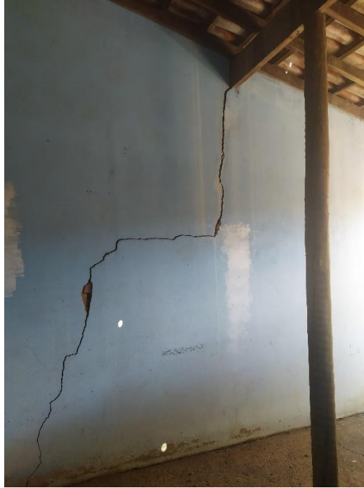
Figura 15 - Fissuração com direção predominante a 45°
