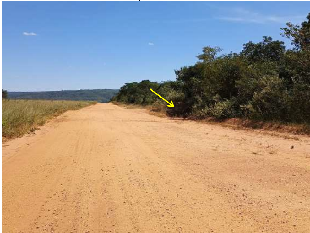
Figura 46: Estradas vicinais com bolsões para contenção de escoamento superficial, indicada pela seta.
