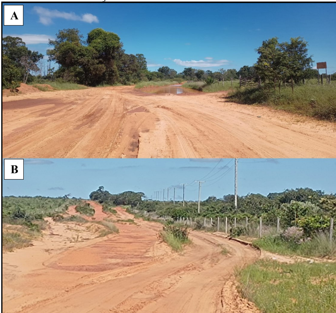
Figura 30: Processos de arenização em estradas não pavimentadas. A: Cabeceira do Ribeirão das Lajes. B: Cabeceira da Vereda do Galhão.
