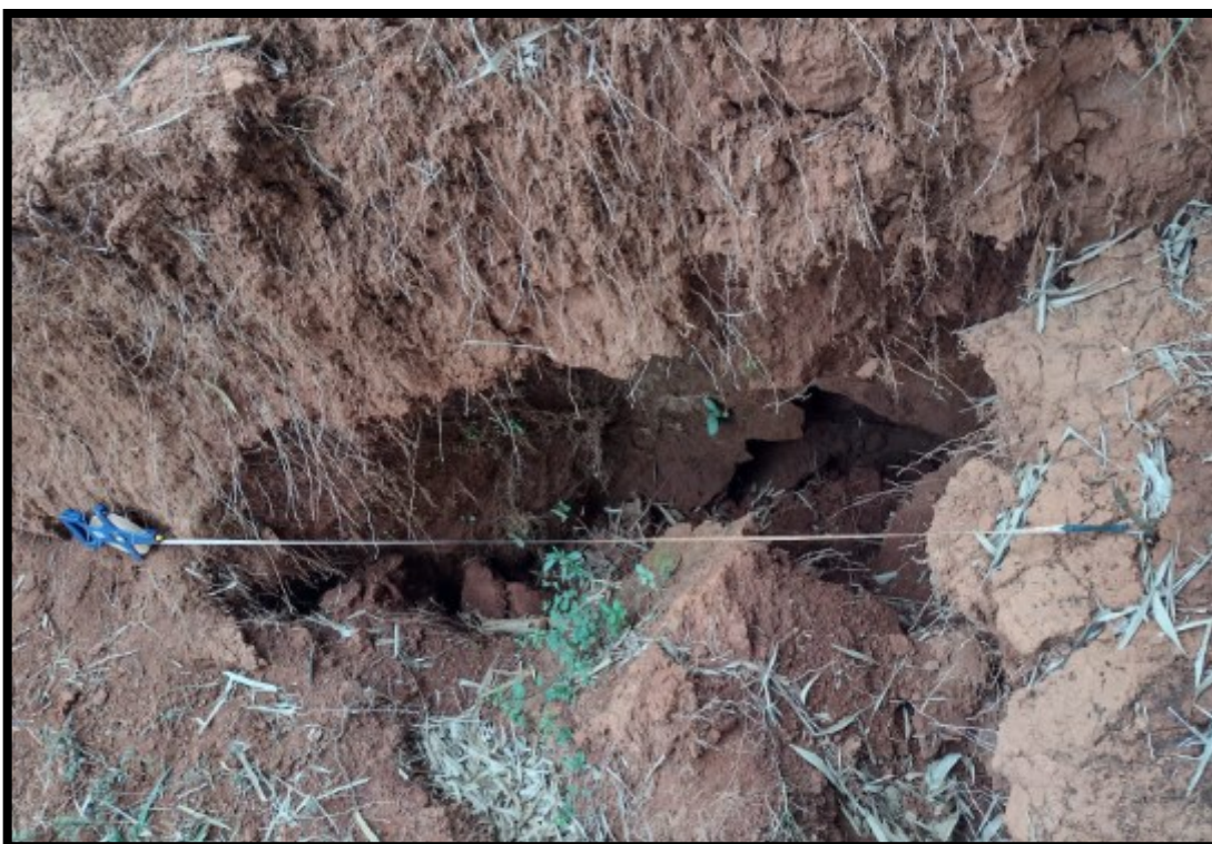
Figura 12a. Buraco com 2 metros de extensão na porção inferior da barragem.
