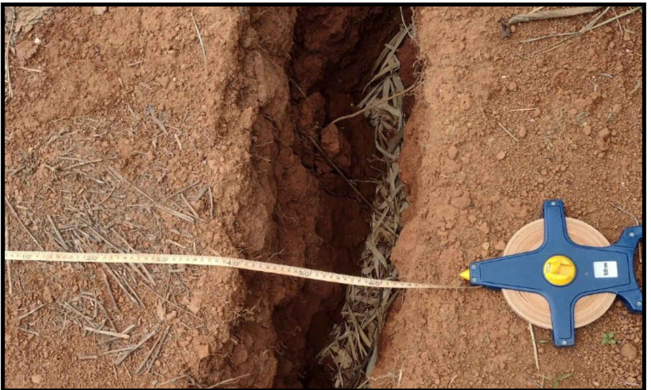
Figura 13. Rachadura de 25 cm na porção superior da barragem.
