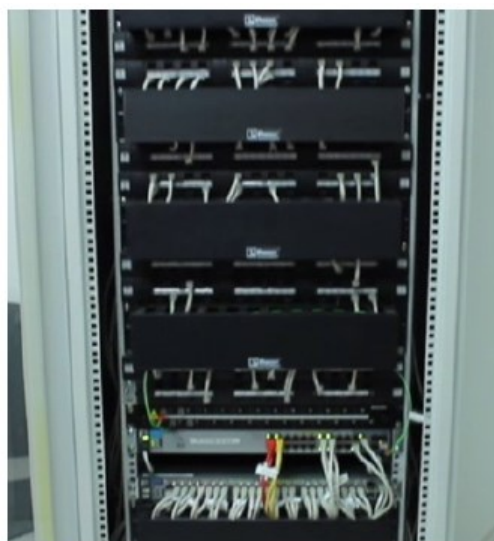
Figura 25: Equipamento de rede utilizado para os testes por Bergenti et al.
