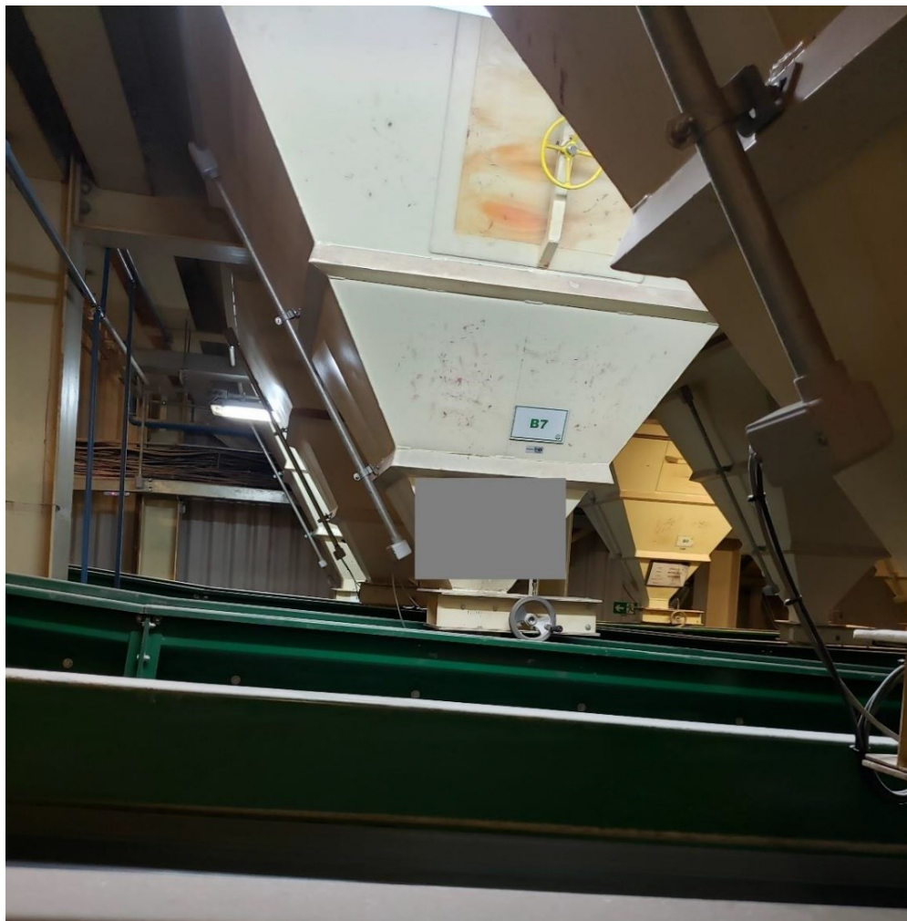
Figura 13 – Boca de saída de um silo.
