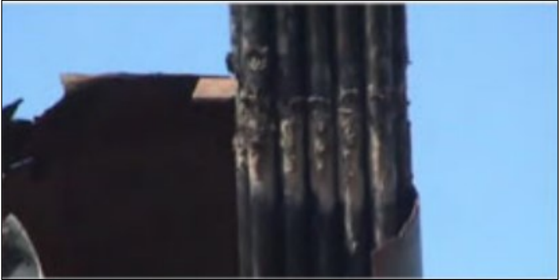
Figura 8 – Danos em componentes não estruturais do cabo.
