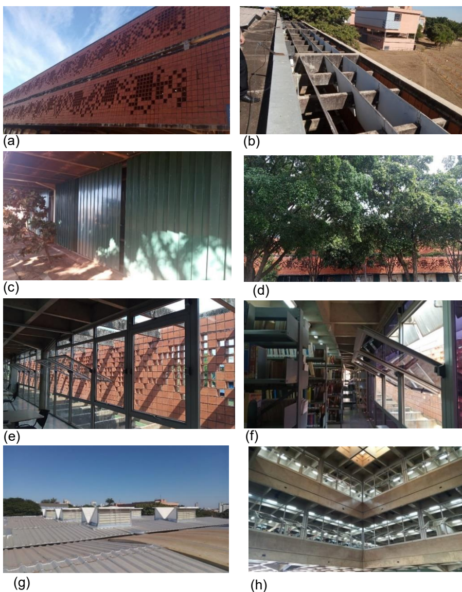
Figura 12 - Elementos para estratégias passivas na Biblioteca. Elementos para sombreamento: (a) brise em cobogó; (b) placas cimentícias, (c) brises metálicos, (d) árvores. Elementos para ventilação natural: (e) janelas basculantes na área de leitura, (f) janelas no acervo de livros, (g) lanternins, (h) átrio.
