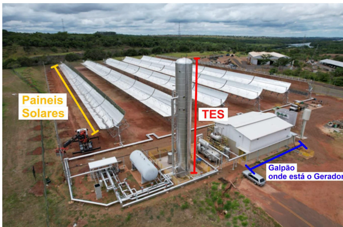
Figura 15 – Usina Solar térmica de P. Primavera – SP
