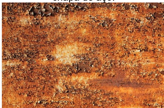
Figura 5 - Corrosão uniforme em chapa de aço.
