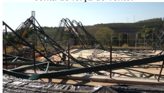
Figura 10 – Estrutura desabada por conta de força do vento.
