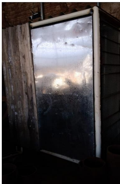
Figura 13: Abrigo do inversor fechada sem circulação de ar.
