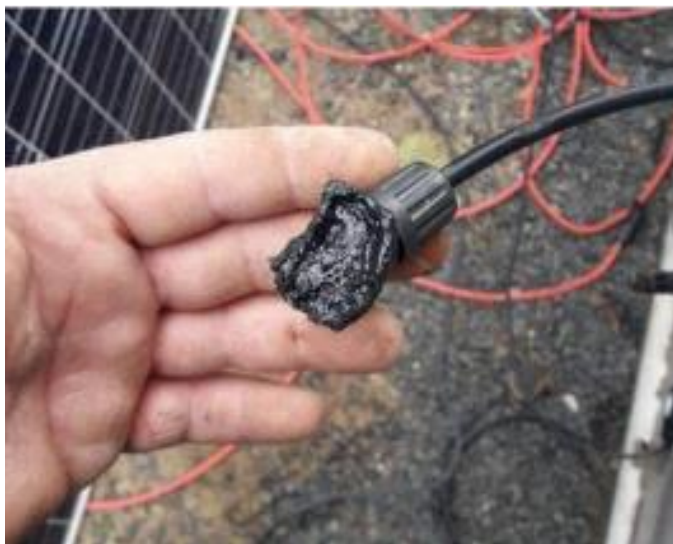
Figura 16: Conectores MC4 com má instalação.
