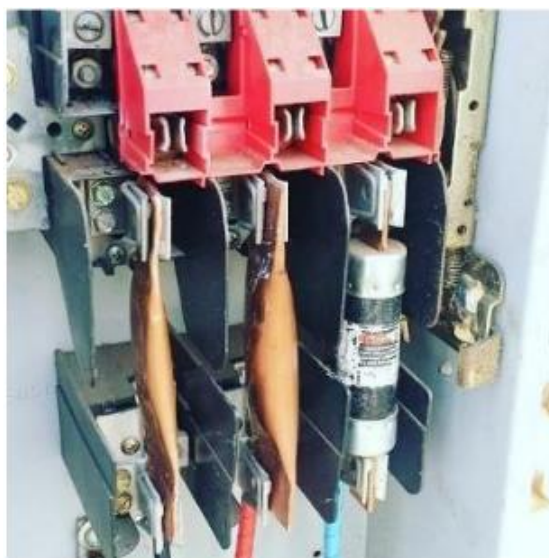
Figura 19: Manutenção inadequada da substituição do fusível.
