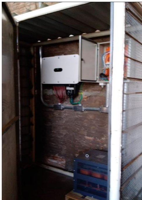
Figura 12: Instalação do inversor em um abrigo metálico com pouca ventilação.
