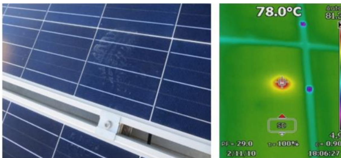
Figura 14: Aquecimento nas microfissuras causados pelos impactos.
