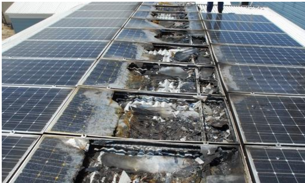
Figura 11: Incêndio nas placas causado pela corrente reversa.
