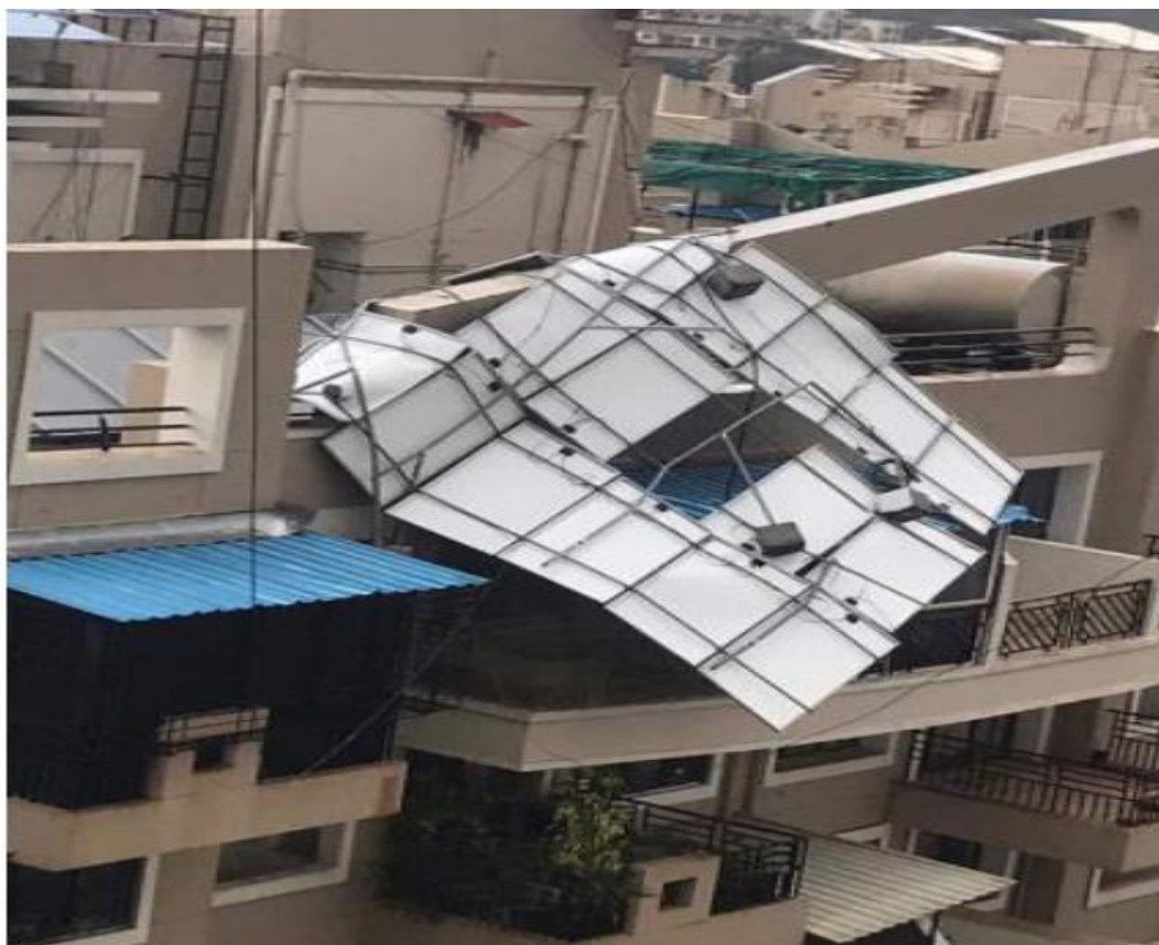
Figura 10: Falha ao dimensionar o suporte da estrutura.
