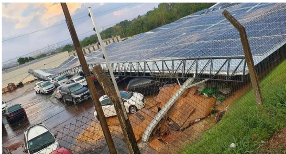
Figura 9: Queda de telhado com placas fotovoltaicas.
