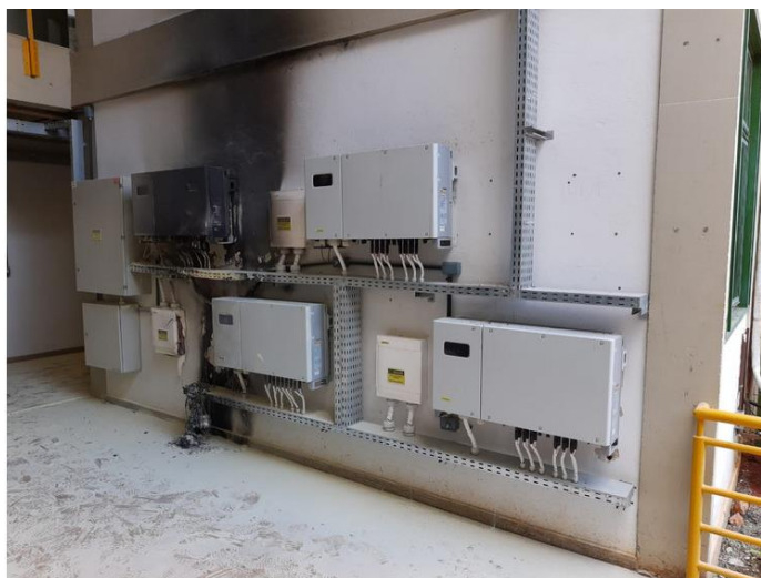
Figura 21: Incêndio ocasionado por arco elétrico no circuito de corrente contínua com inversor.
