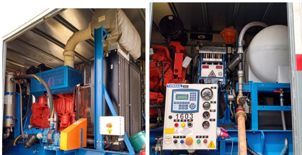
Figura 3.10 - Motor e painel de controle da bomba de hidrojato de alta pressão utilizado da fabricante LEMASA, modelo L-300/4 (Fonte: Autor da Obra).
