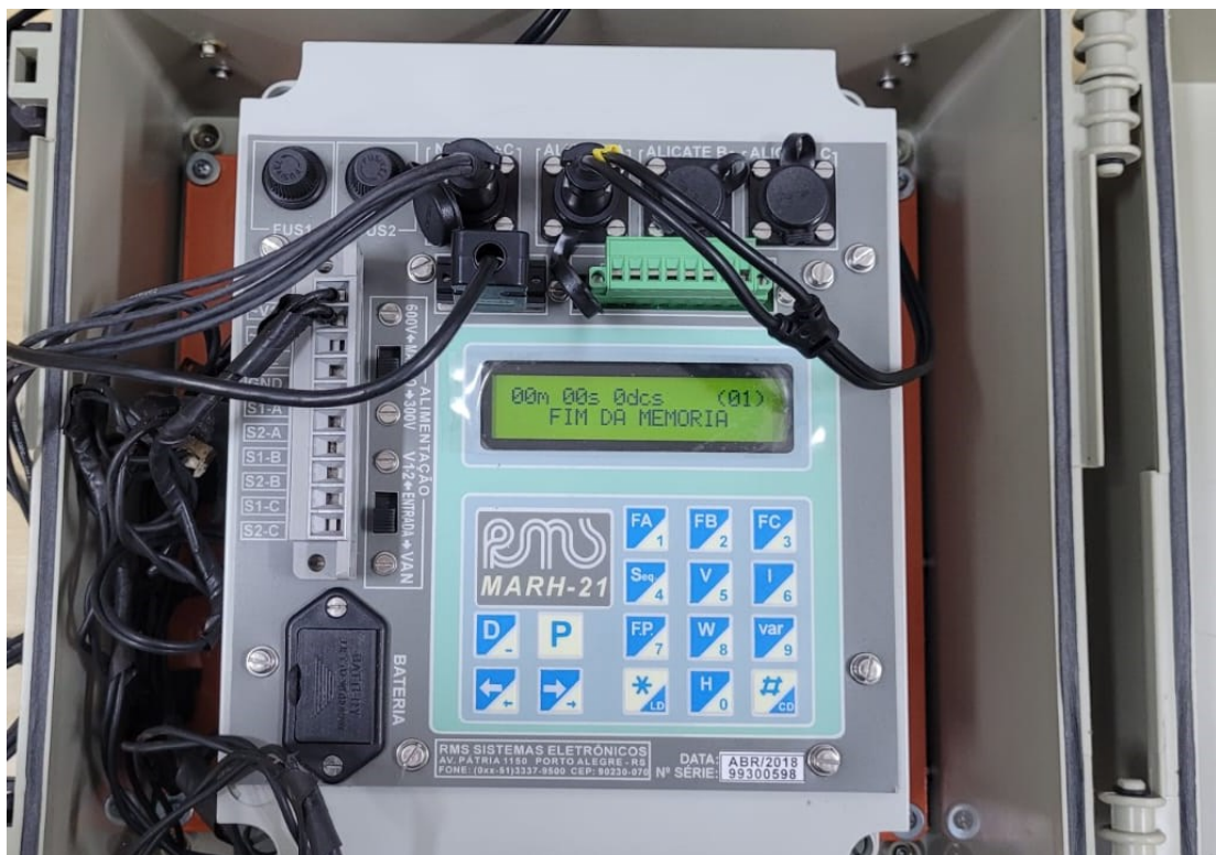
Figura 5.3 – Medidor de QEE e de forma de onda utilizado na medição.
