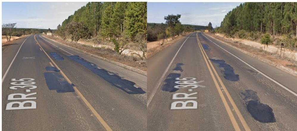
Figura 20 – Parte do Trecho F, em destaque as condições do pavimento
