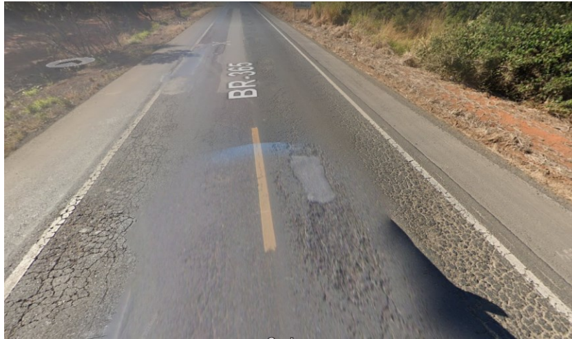
Figura 22 – Parte do Trecho G, em destaque as condições de sinalização horizontal e pavimentação
