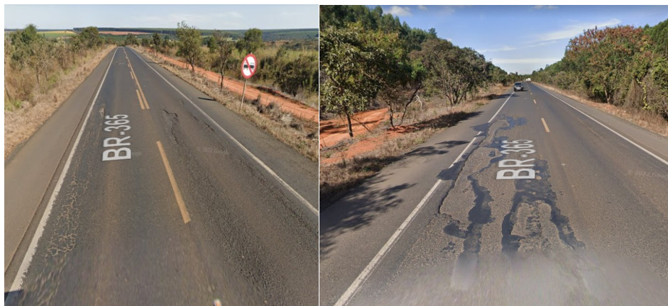
Figura 15 – Parte do Trecho E, em destaque as condições do pavimento
