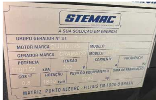
Figura 21 – Dados de placa do gerador
