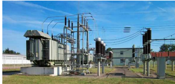
Figura 3 – Subestação ao ar livre em estrutura de alvenaria
