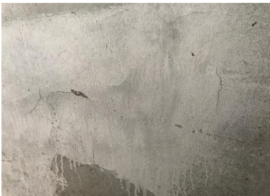
Figura 16: Fissuração devido a retração
