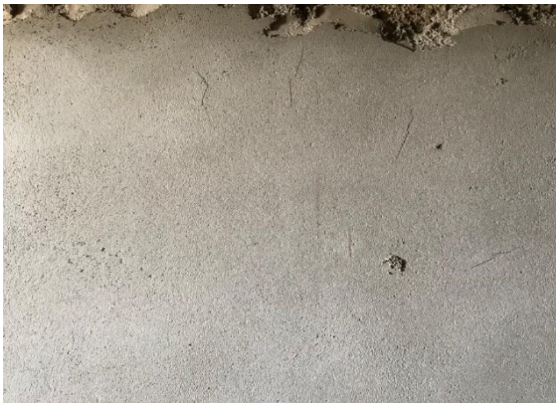
Figura 15: Fissuração em argamassa
