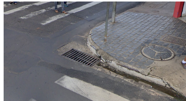
62. Boca de lobo na esquina. Fonte: Google Earth.
