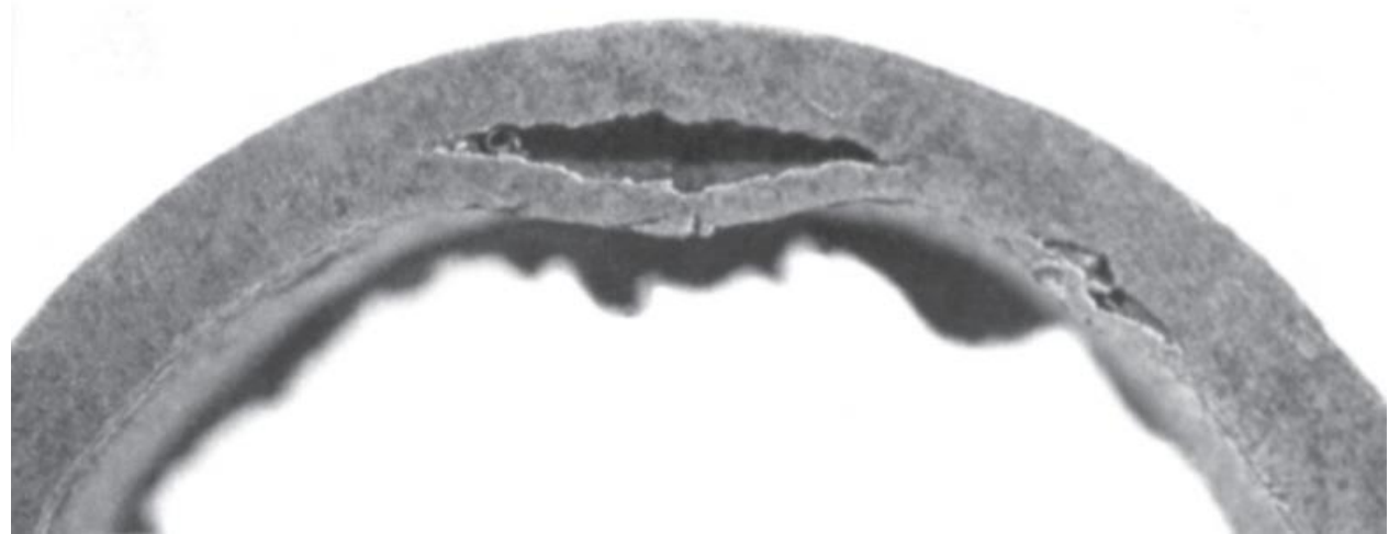
Figura 4: Secção de tubulação com empolamento pelo H_2 ocasionado por gás sulfídrico e umidade
