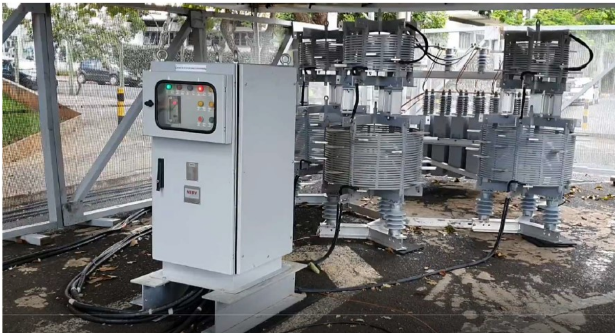
Figura 5.6 – FMBT montado para os ensaios na subestação 6 da UFU no campus Umuarama.
