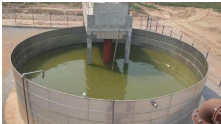
Figura 3 - Tanque de equalização.
