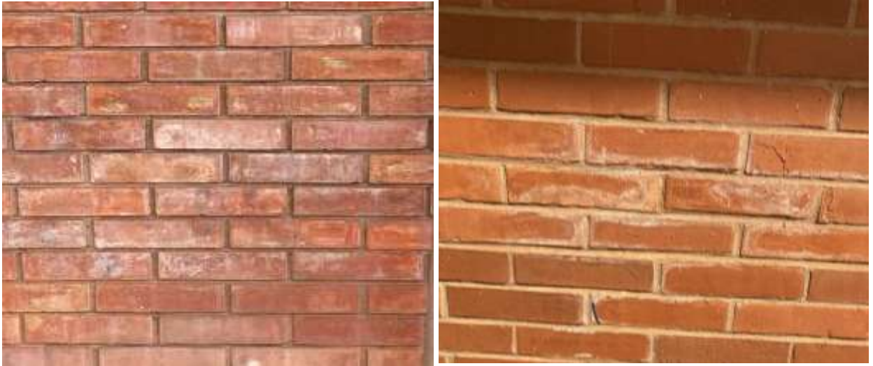
Figura 4 – Eflorescências (a) x Criptoflorescências (b).
