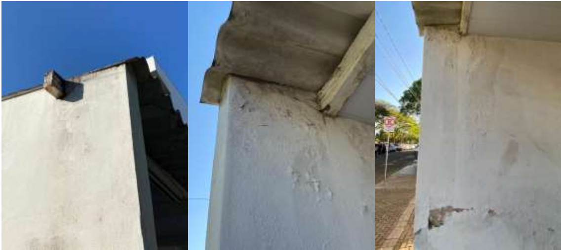
Figura 16 - Detalhes da parede: locais de vulnerabilidade à umidade por intempéries.
