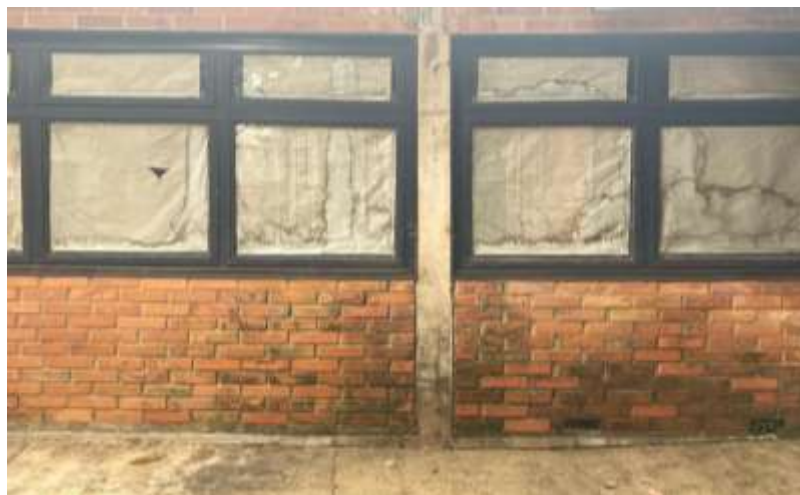
Figura 21 - Recalque observado na área de concentração de umidade.
