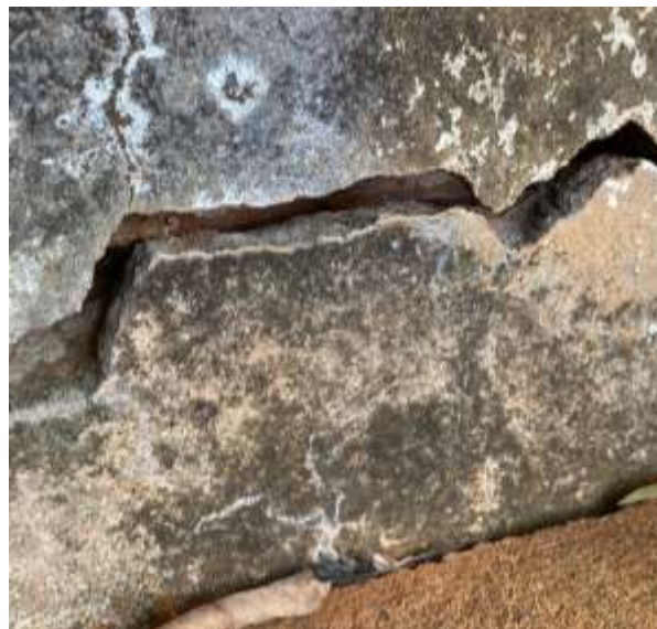
Figura 19 - Abertura da trinca no ponto mais crítico.
