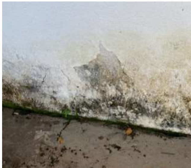
Figura 5 – Presença de mofo e bolor e deslocamento da pintura.
