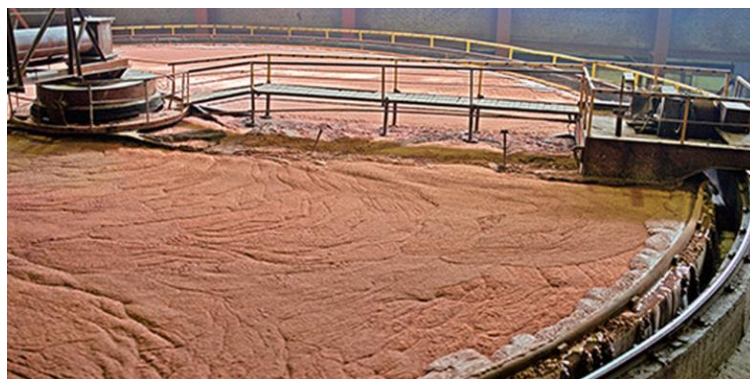
Figura 6 - Flotador utilizado para o tratamento de efluentes.
