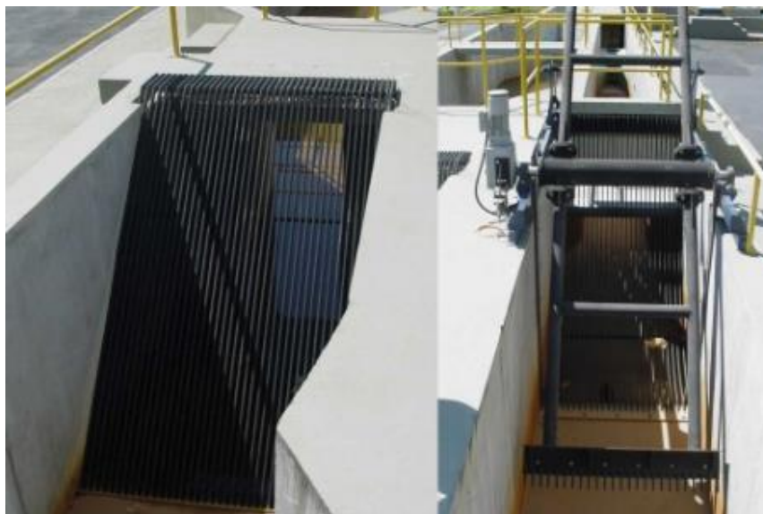
Figura 3 - Grade de contenção para tratamento preliminar de efluentes
