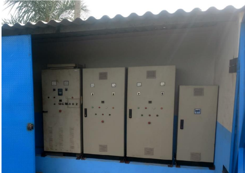
Figura 16 – Sala comando e acionamento Motobombas e banco de capacitores.
