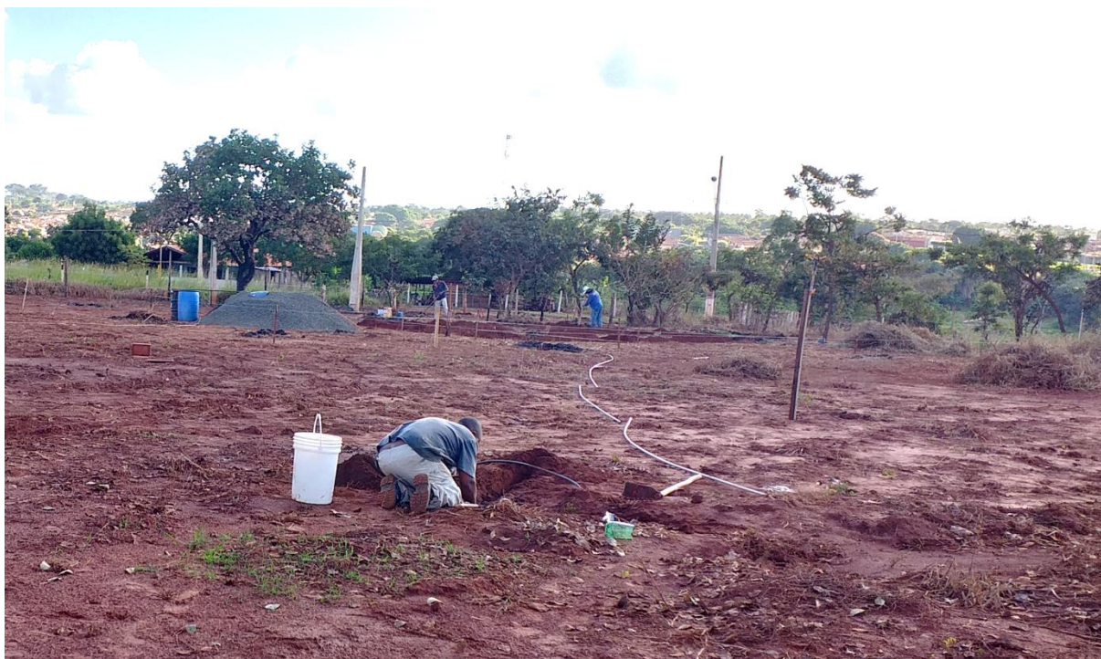
Foto 5-Ituiutaba (MG): Instalação subterrânea de microaspersores de horta em expansão
