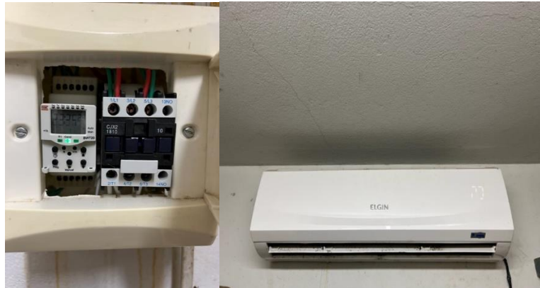
Figura 44 e 45: Controlador do fotoperíodo e ar condicionado para controle da temperatura do ambiente.
