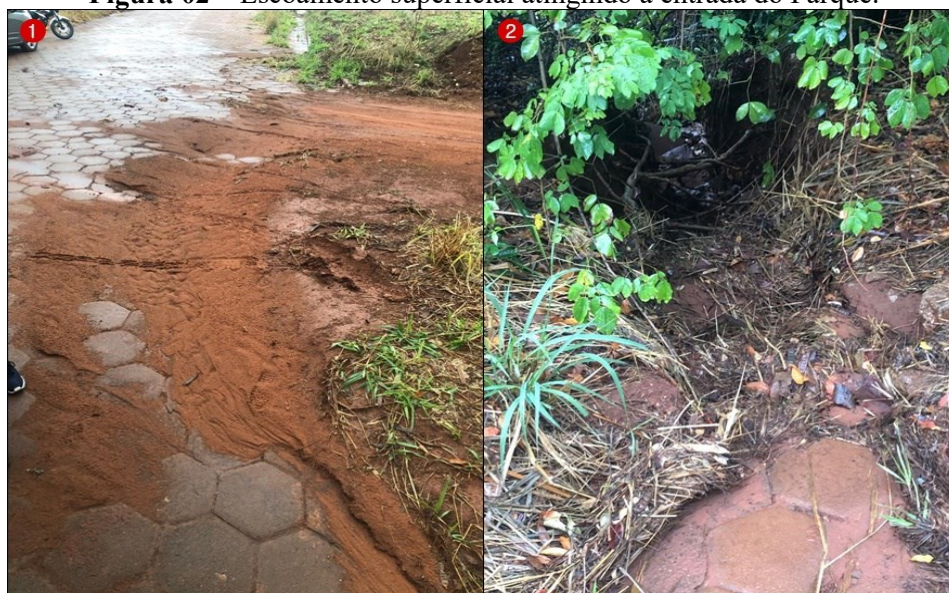
Figura 02 – Escoamento superficial atingindo a entrada do Parque.
