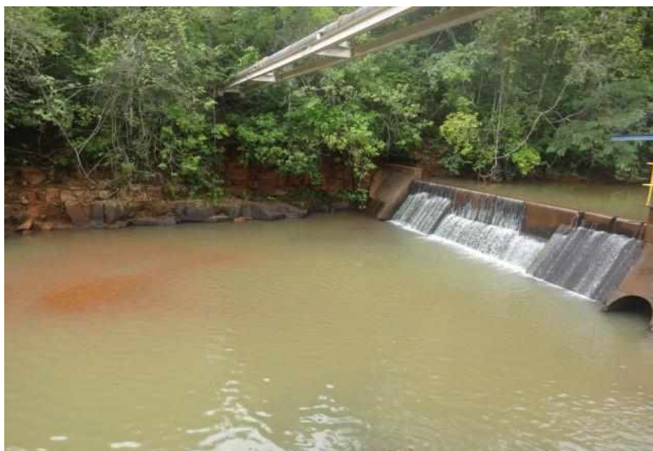
Figura 04: Estação de captação principal no Ribeirão São Lourenço
