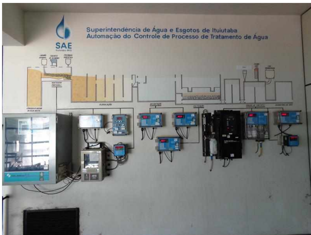
Figura 06: Sistema automatizado do controle de processo de tratamento de água pela Superintendência de Água e Esgoto (SAE) de Ituiutaba/MG
