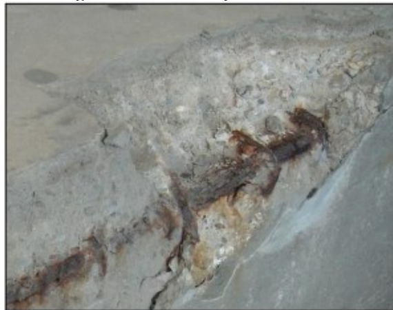
Figura 8: Carbonatação no concreto
