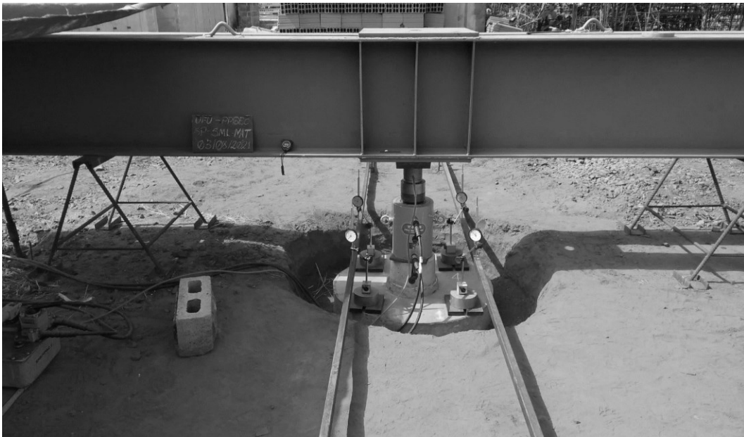
Figura 63. Viga de reação posicionada para a prova de carga da sapata isolada.
