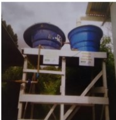
Figura 13 – Caixas d'água para aproveitamento de águas pluviais
