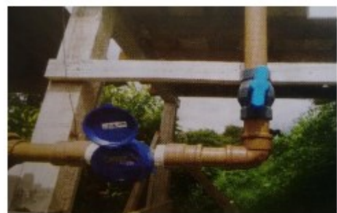
Figura 14 – Canos de PVC e válvula de retenção de um sistema de aproveitamento de águas pluviais
