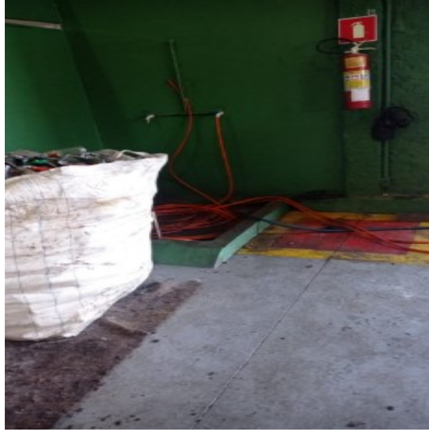
Foto 11: Mangueira em local inapropriado e EPI guardado em local incorreto
