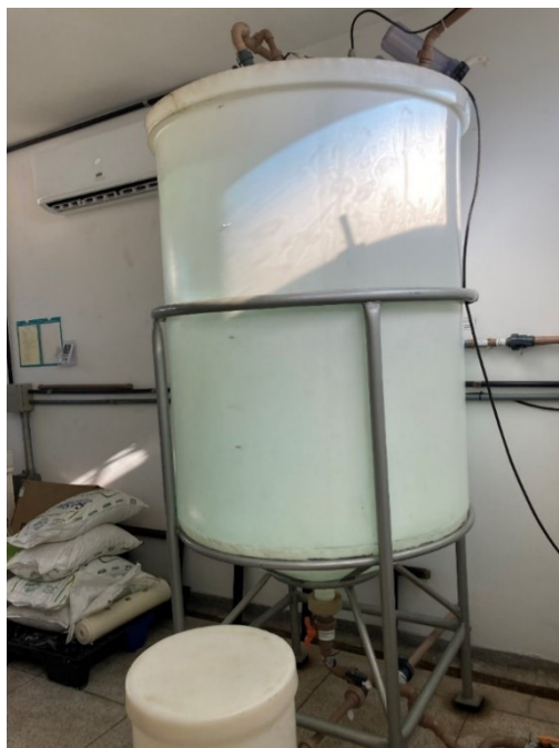
Figura 11 – Tanque de Armazenagem de Água Tratada do STAH do HC-UFU
