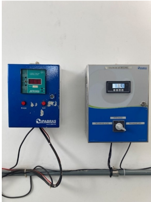
Figura 10 – Mostradores de Condutividade do STAH do HC-UFU
