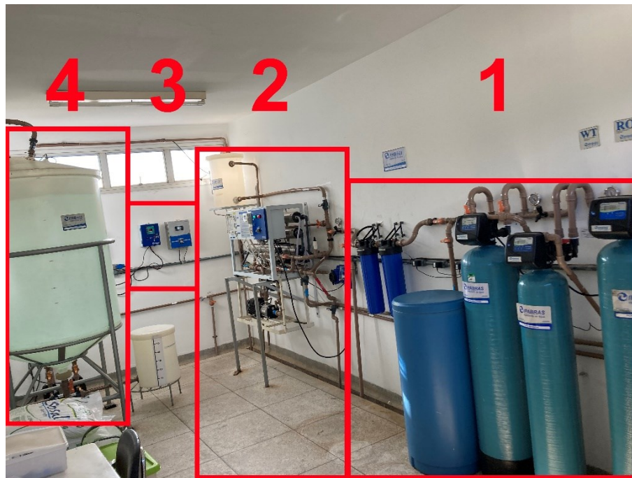
Figura 3 – Subsistema de Tratamento de Água para Hemodiálise do STDAH do HC-UFU
