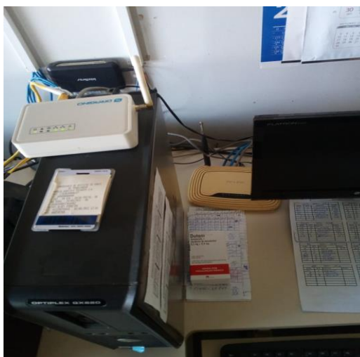
Figura 5.1 - Gateway LoRa no escritório da granja
