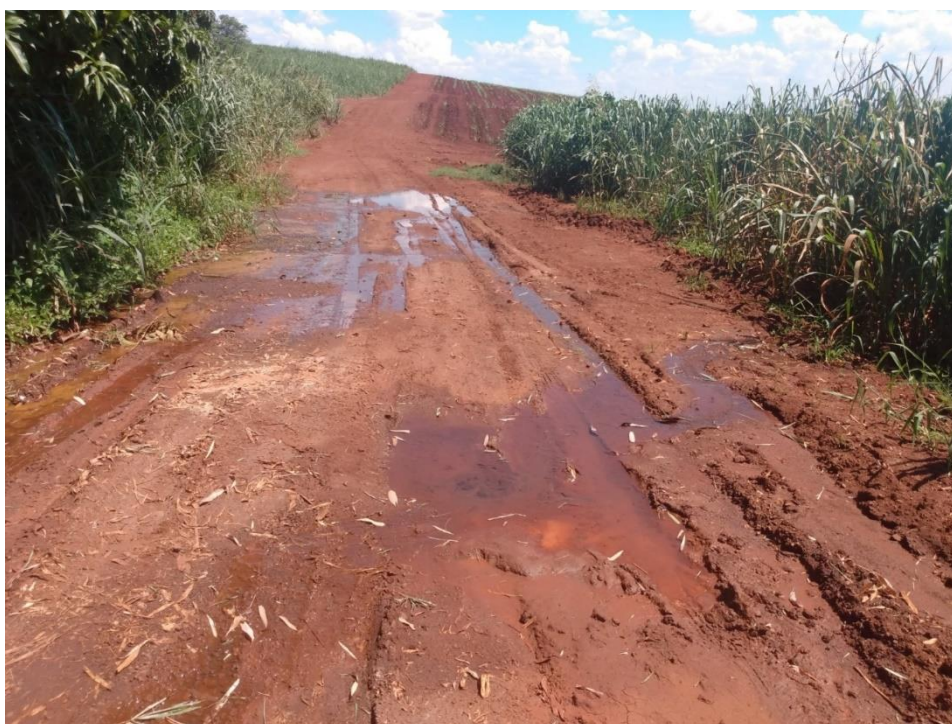
Figura 25 – Estrada em área de nascente do Córrego Palmital.
