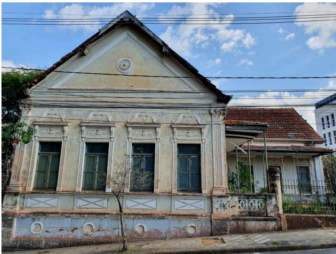
Figura 31 - imóvel situado na Rua Lauro Borges, n. 152, em estado precário de conservação e sem uso
