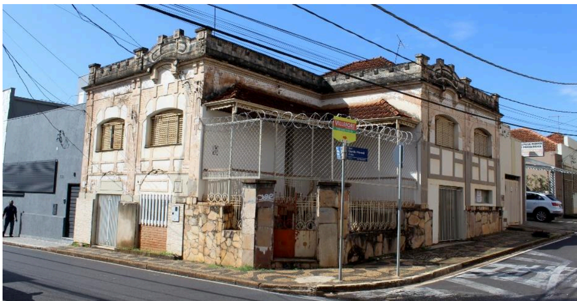
Figura 33 - Imóvel da Rua Carlos Rodrigues da Cunha, n. 148, em estado regular de conservação. Detalhe da substituição de esquadrias e inserção de gradis
