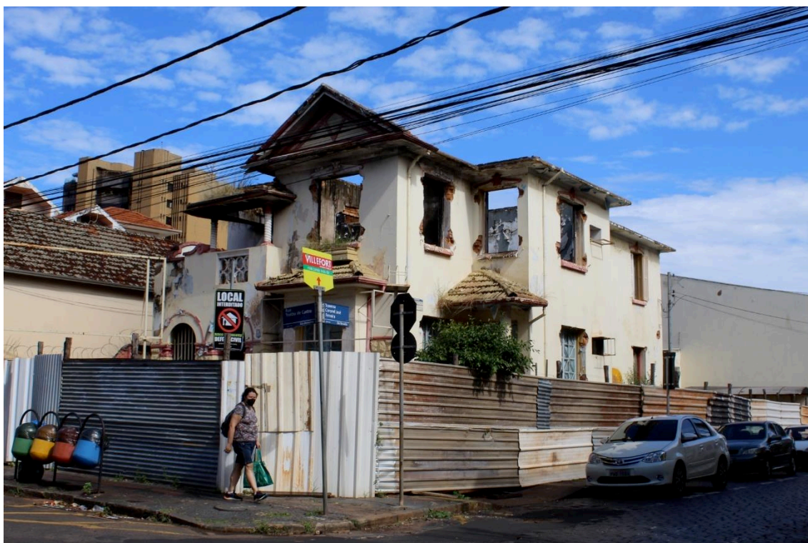
Figura 47 – Imóvel neocolonial da Rua Tristão de Castro, n. 266, abandonado após um incêndio, ocorrido em 2017
