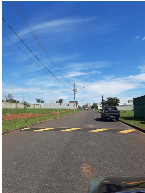
Figura 14 – Lombada sem sinalização vertical
