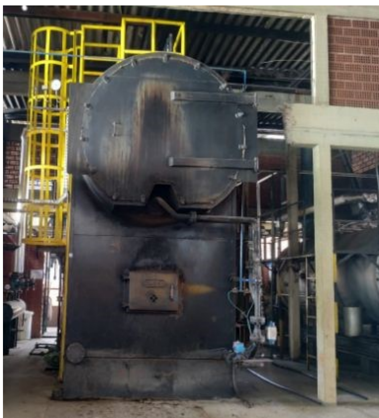
Figura 2 – Caldeira utilizada na lavanderia em estudo.
