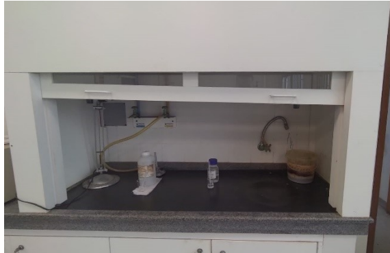
Figura 2 – Capela de um dos laboratórios da Universidade Federal de Uberlândia.
