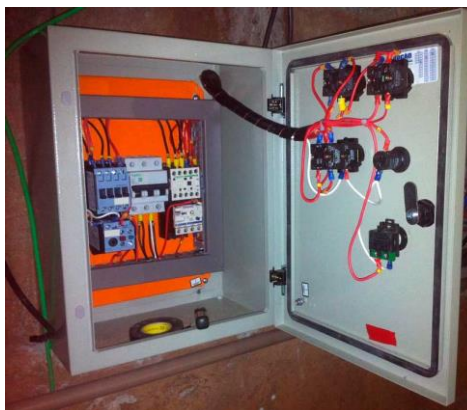
Figura 2.25 – Quadro de comando com seus componentes.
