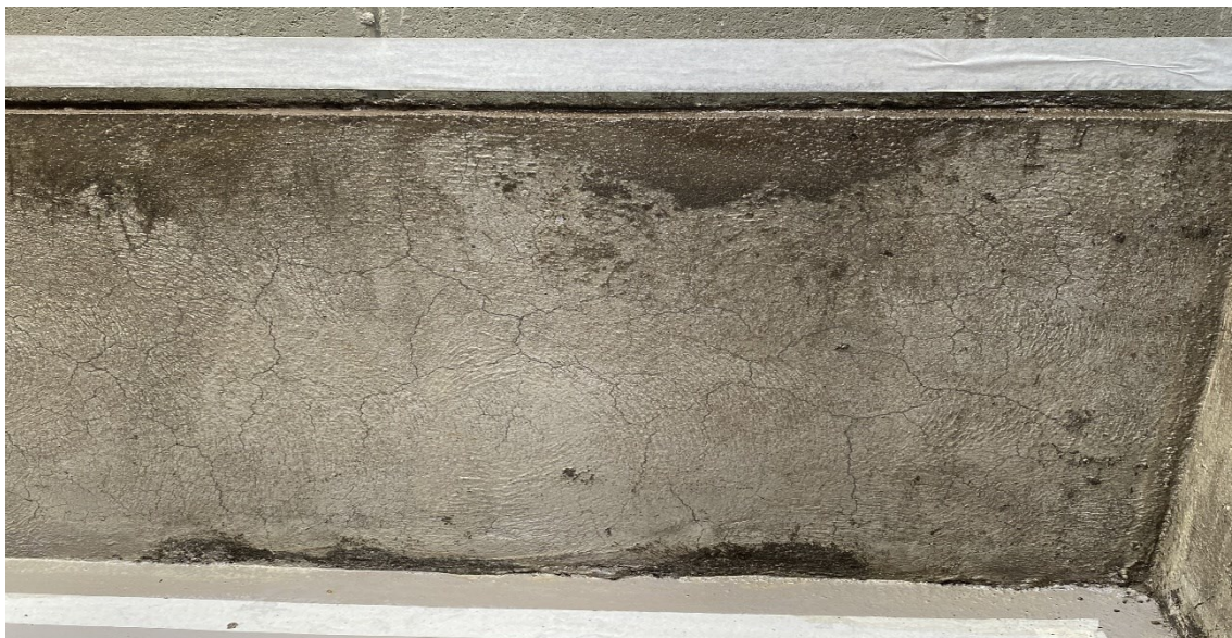
Figura 14 – Fissuras de retração anterior à aplicação do uretano
