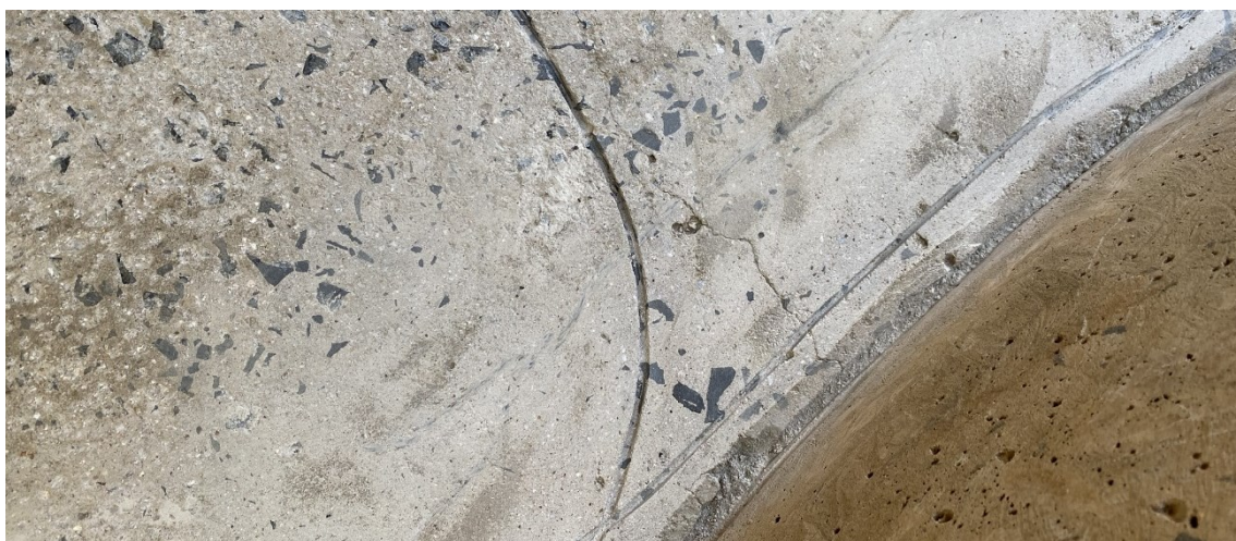
Figura 15 – Exemplo de fissuras encontrada durante a inspeção visual
