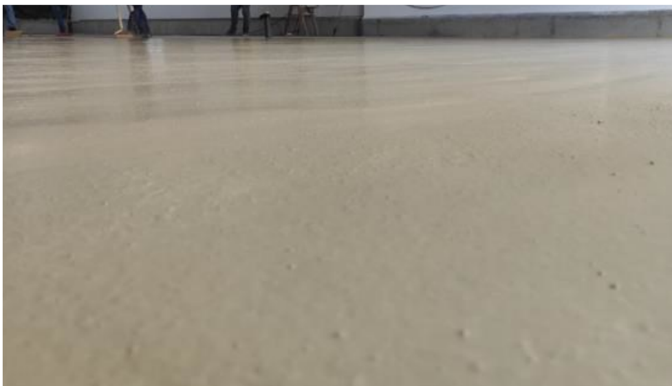
Figura 8- Presença dos micro furos do revestimento anterior
