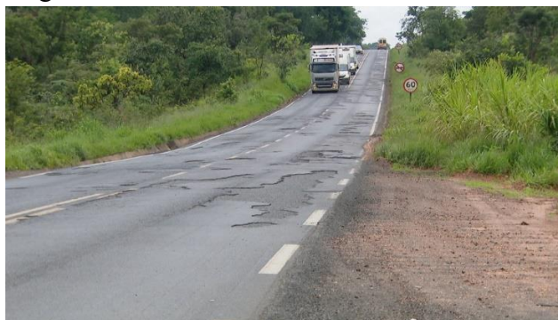
Figura 5 – Trecho desgastado da MGC-497 entre as cidades de Prata e Uberlândia MG.
