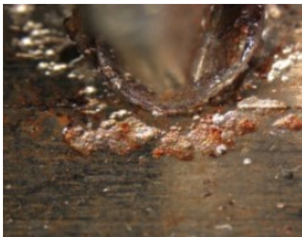
Figura 7 – Corrosão em zona soldada. Fonte: (HINDAWI, 2018)
