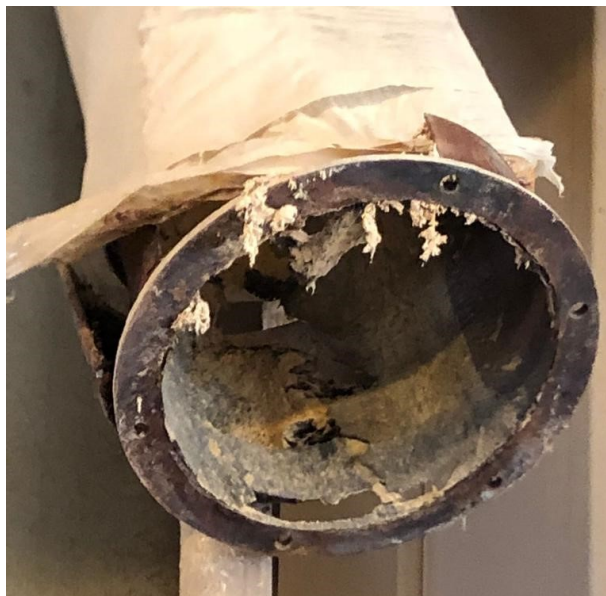
Figura 1 – Tubulação de transporte de trigo úmido deteriorada devido a corrosão.
