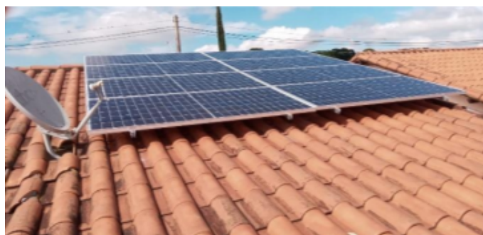
Figura 37 – Módulos no telhado do cliente B
