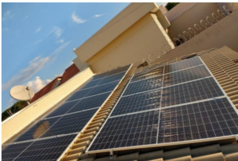
Figura 35 – Módulos instalados no cliente A
