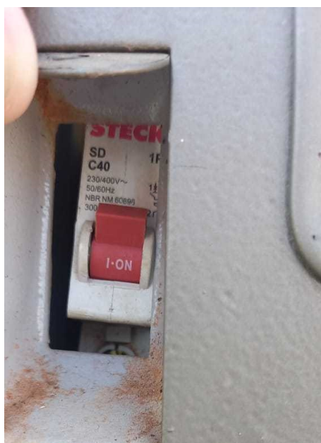
Figura 1 – Foto do disjuntor de entrada do cliente A
