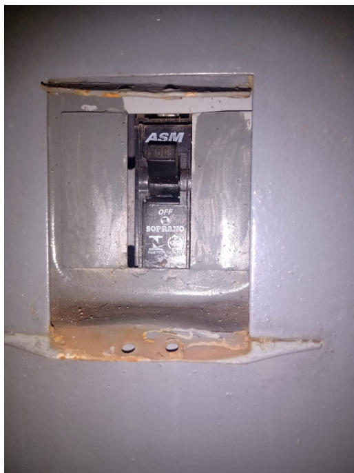
Figura 2 – Foto do disjuntor de entrada do cliente B
